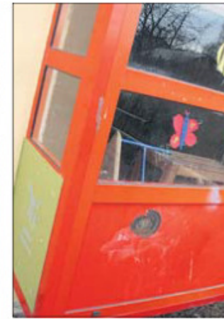
Hier stiegen die Täter ein, nachdem sie eines der Bleche (links unten) herausgebrochen hatten.
